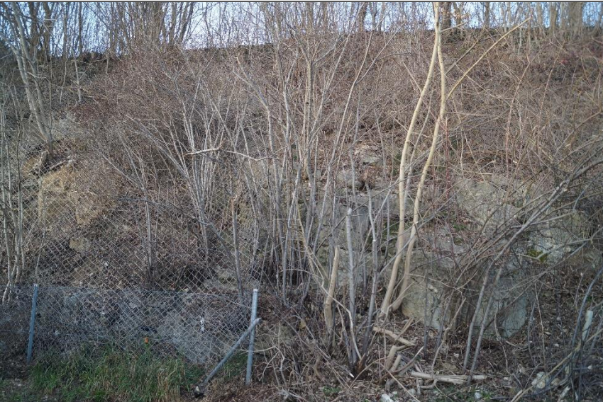
Abruptes Ende des 1.5 m hohen Zauns an einer Böschung gleich nach der Einfahrt
