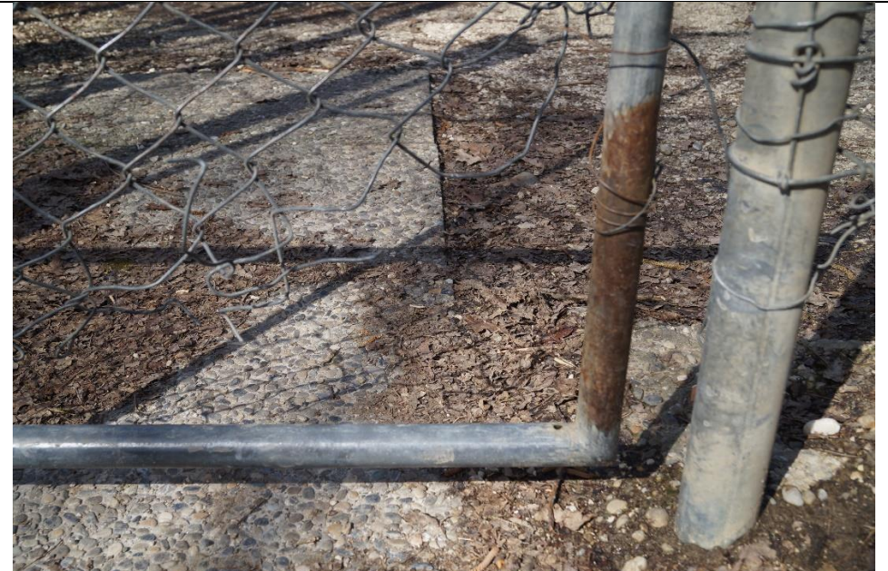
Bodennaher Drahtdefekt an der Schwenktüre
