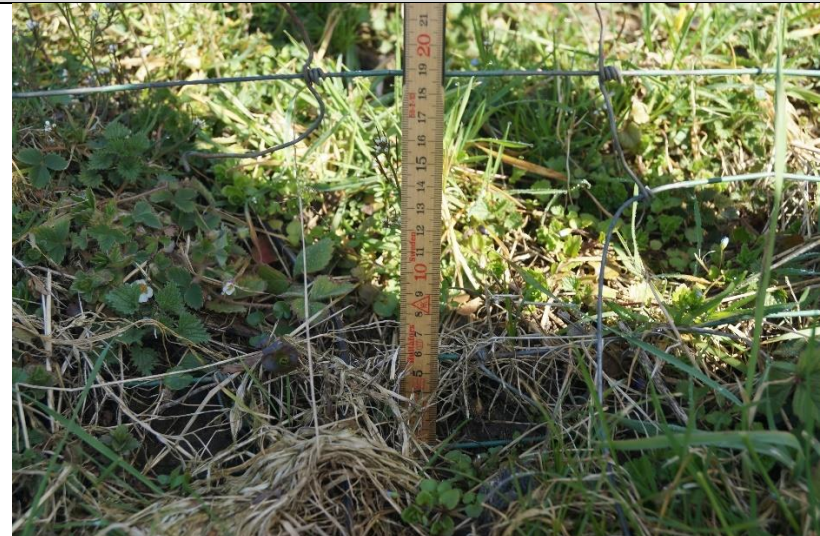
Bodennaher Defekt des Zauns
