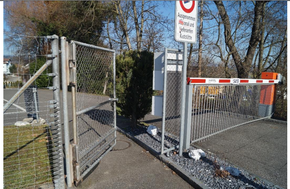
Nicht verschliessbare Schwenktüre mit grösserem Maschendefekt in der Mitte neben Barriere mit fehlendem Bodenschluss
