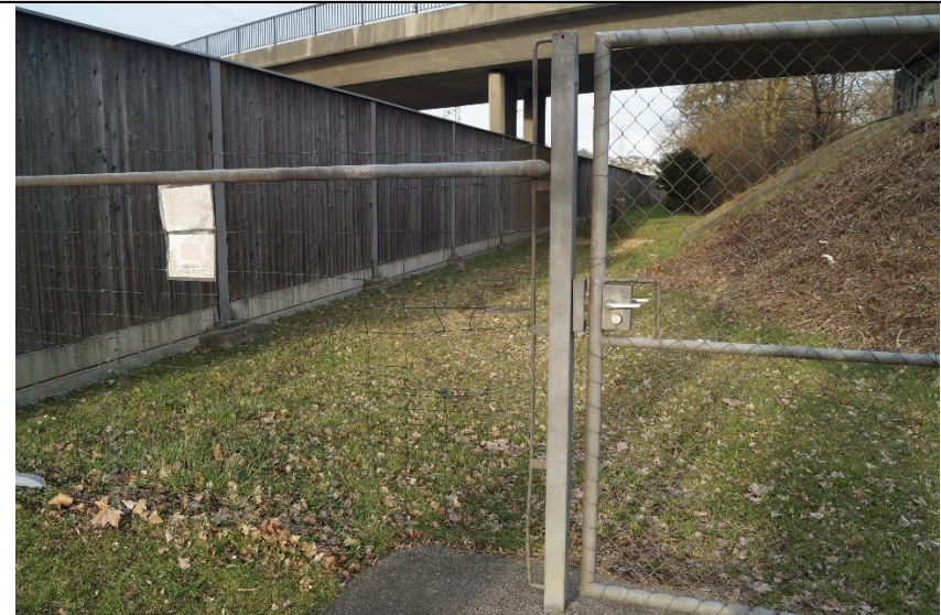
Verschlossene Zauntüre mit grösserem Maschendefekt links der Türe
