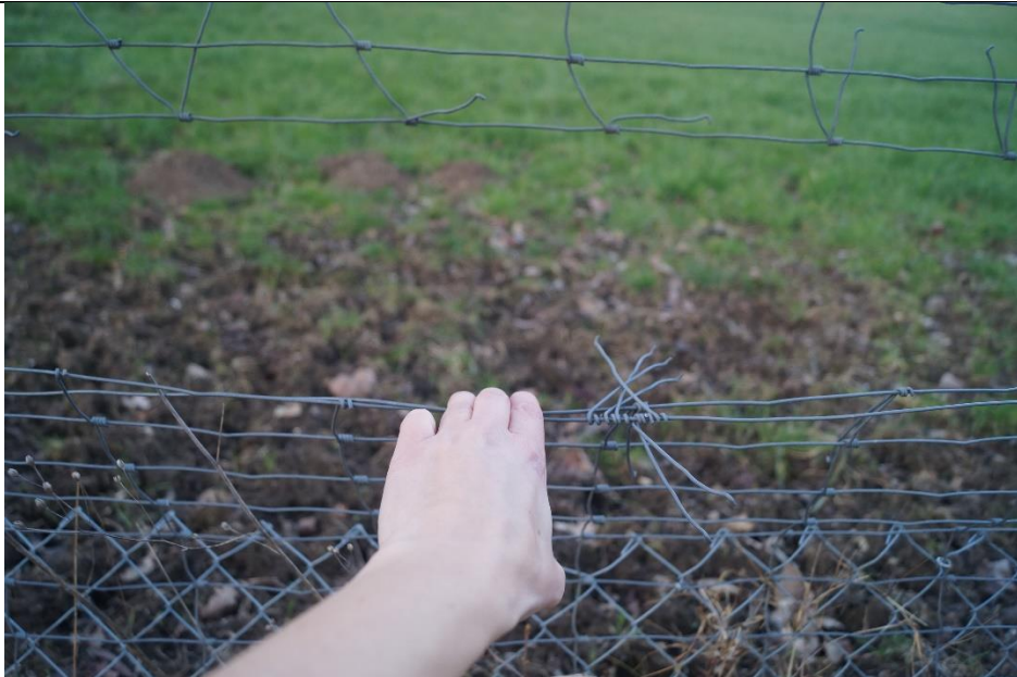
Defekte im Knotengitterzaun im Picknickareal
