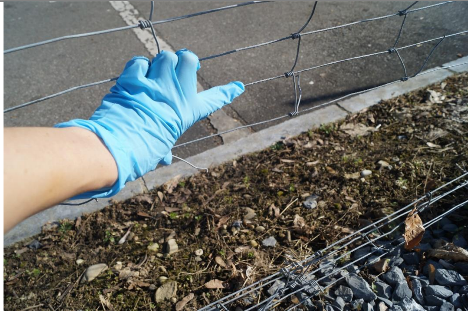
Grösserer Defekt im engmaschigeren Bereich eines Zaunabschnitts
