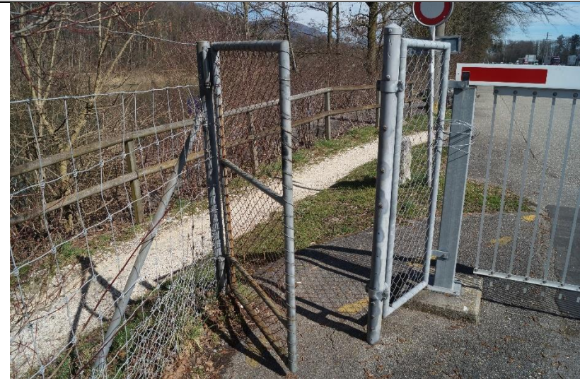
Schwenktüre gleich neben Barriere und Knotengitterzaun von 1.55 m Höhe
