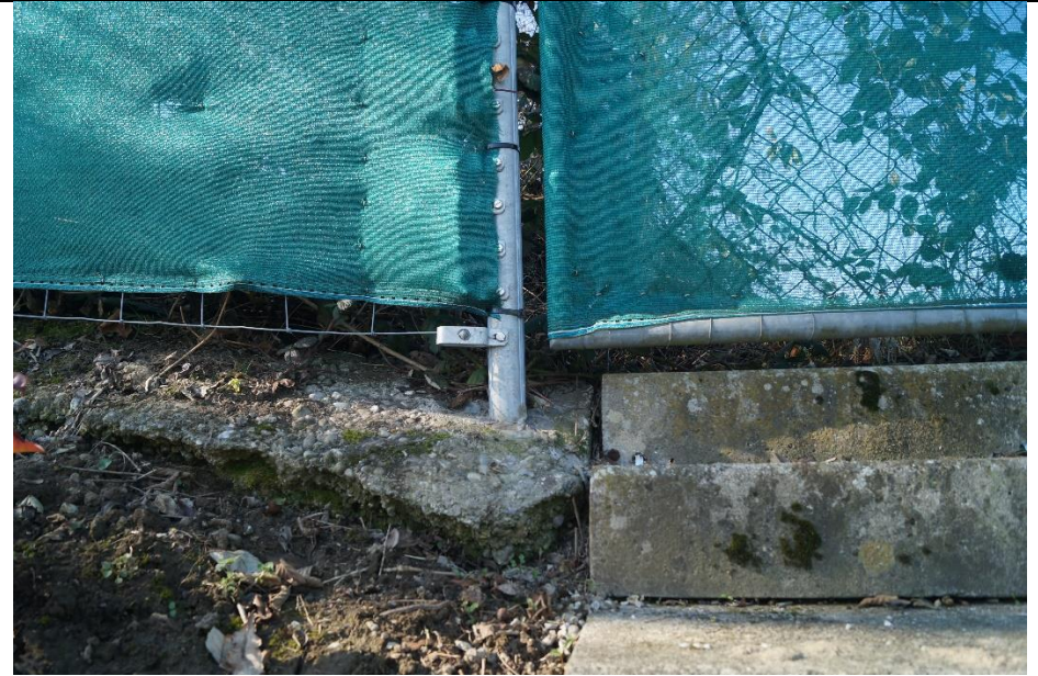
... allerdings aufgrund des Geländes teilweise mit fehlendem Bodenschluss
