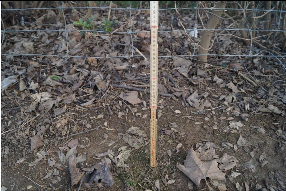
Fehlender Bodenschluss des Knotengitterzauns mit 35 cm Abstand zum Grund
