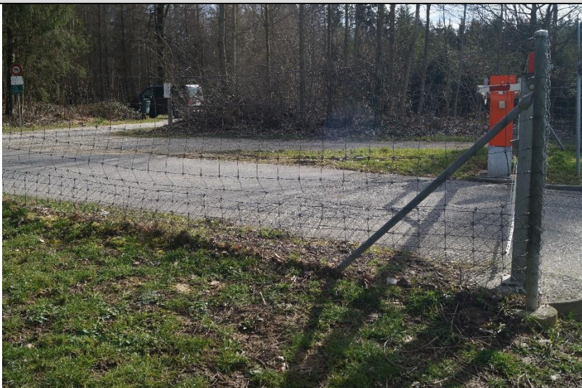
Grössere Defekte am Knotengitterzaun
