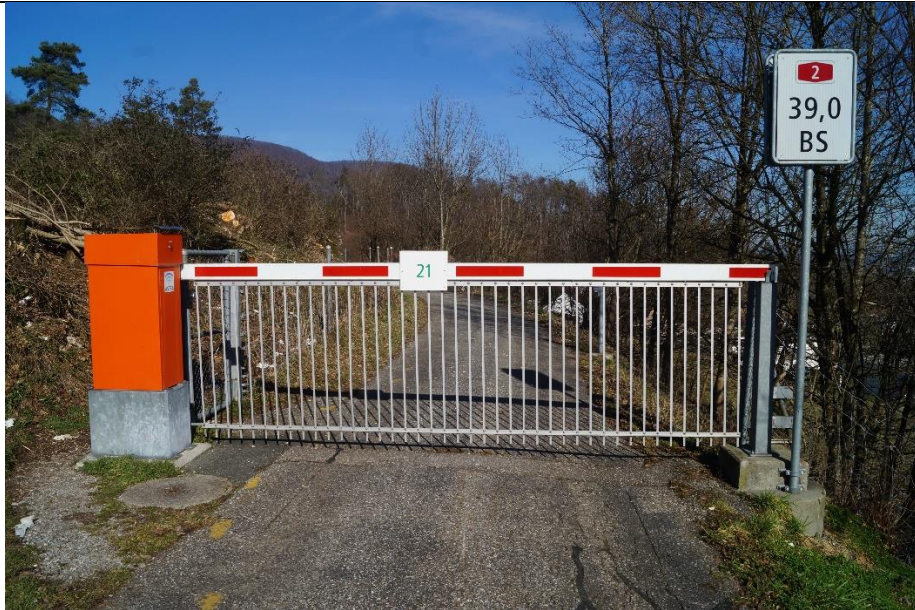
Barriere für eine Zufahrtsstrasse
