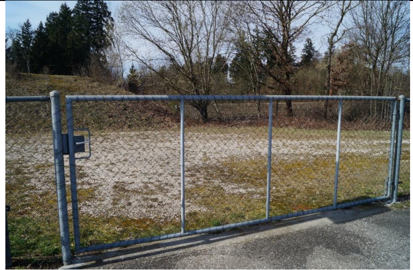
Einwandfreies und verschlossenes Zauntor
