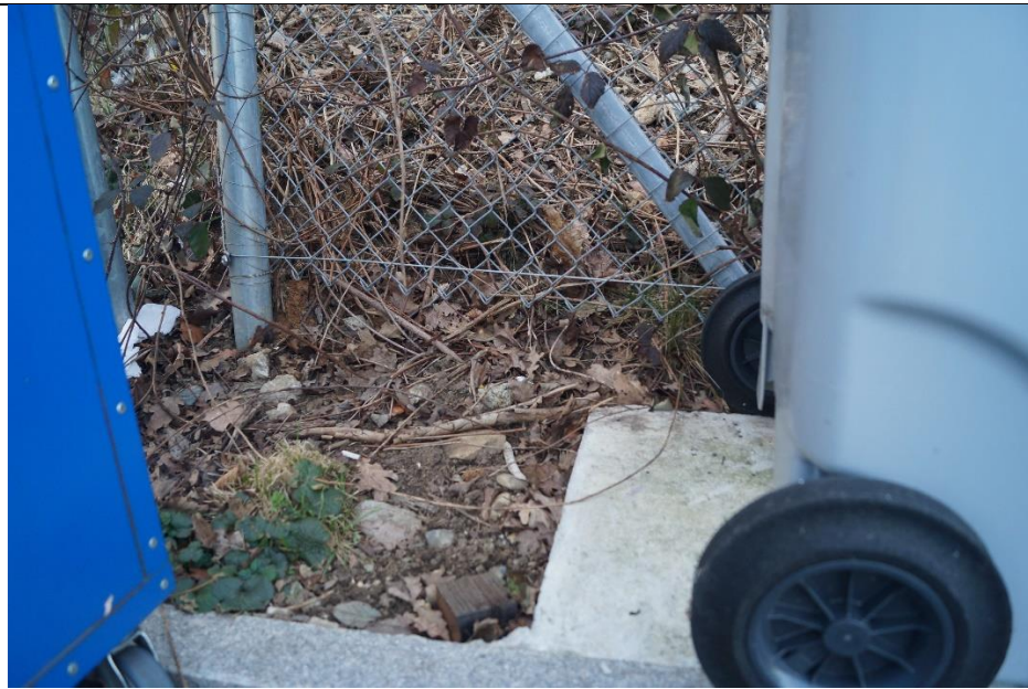
Fehlender Bodenschluss des Knotengitterzauns am Parkplatz
