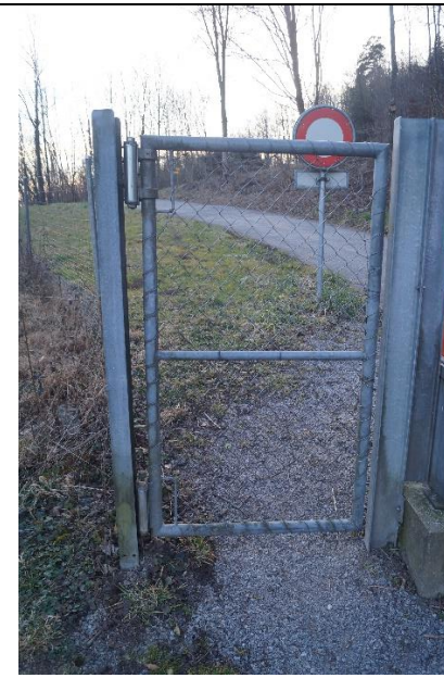
Nicht verschliessbare Schwenktüre neben einer Barriere
