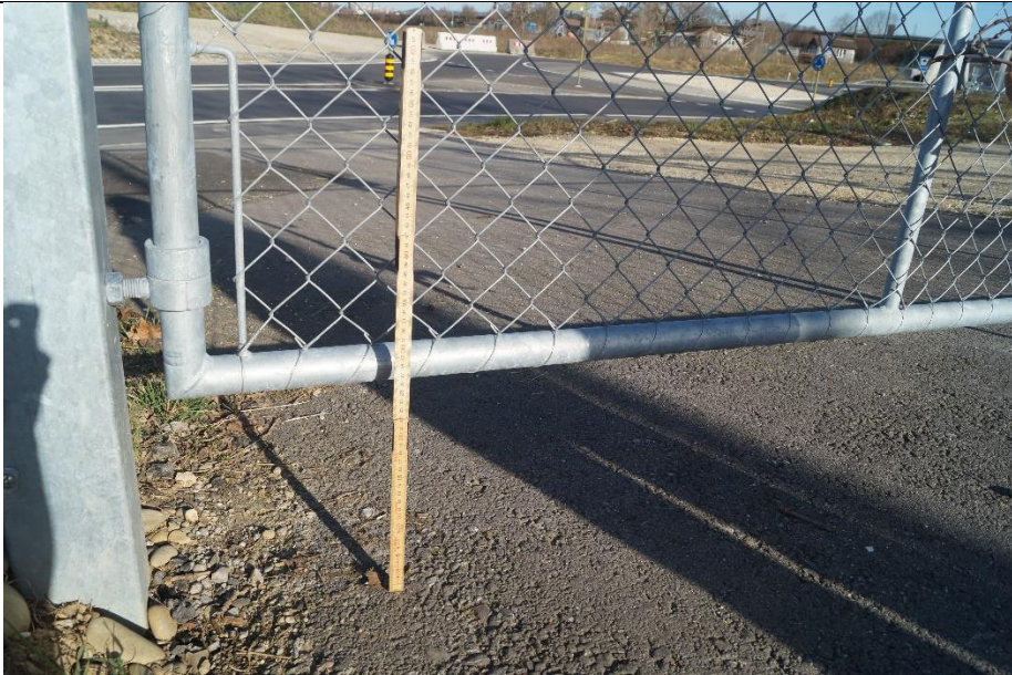
Fehlender Bodenschluss des massiven Zauntors mit 26 cm Abstand zum Grund
