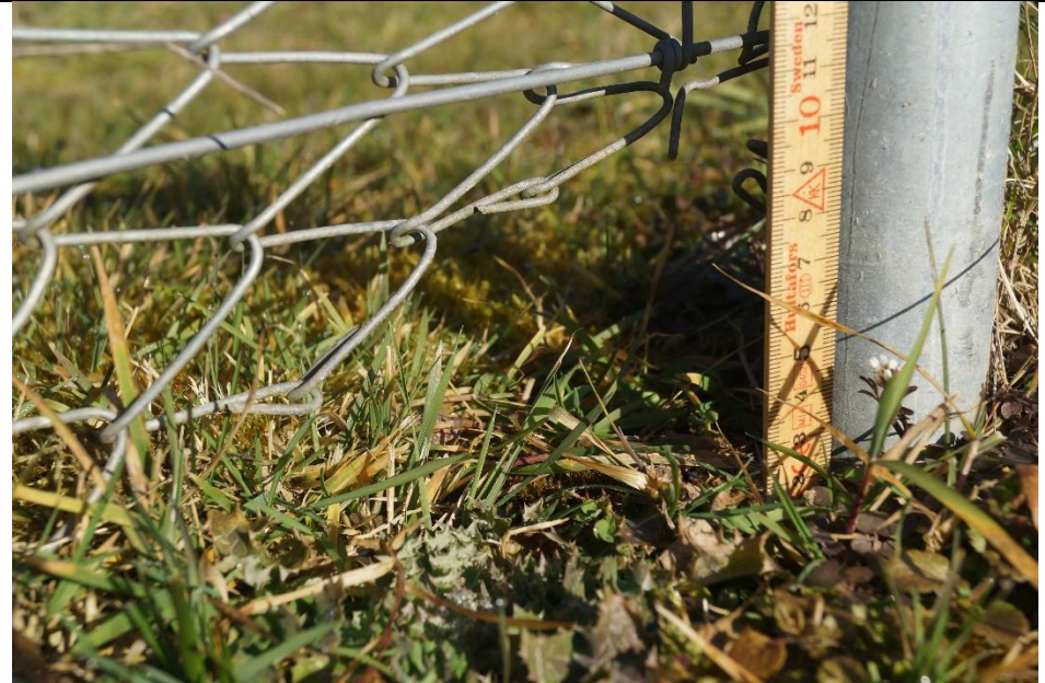
Wenige kleinere Defekte in Bodennähe
