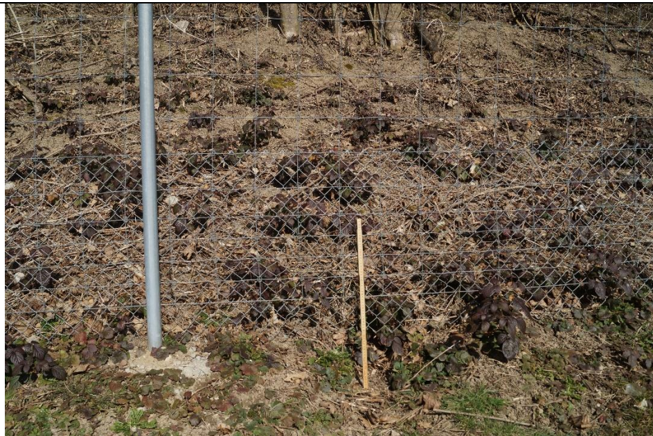
Im unteren Bereich engmaschiger Knotengitterzaun, jedoch mit fehlendem Bodenschluss
