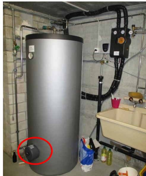
Abbildung 3: Solare Warmwasseranlage mit falscher Position des Elektroheizstabs und damit elektrischer Durchladung des Speichers.
