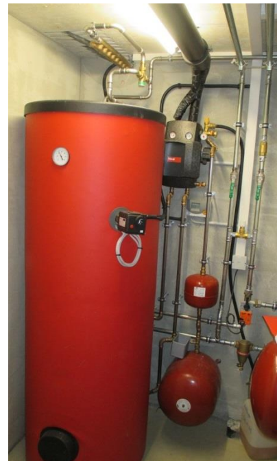
Abbildung 4: Solare Warmwasseranlage ohne Dämmung der Leitungen.
