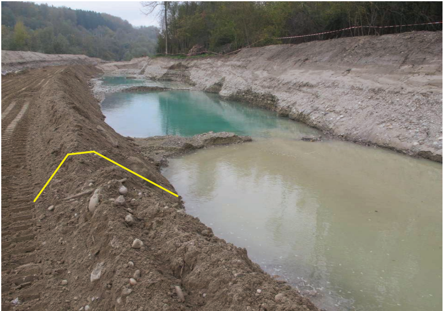
Becken für Versorgen von Knöterichaushub □ Schutzdamm gegen Treibgut Knöterich
