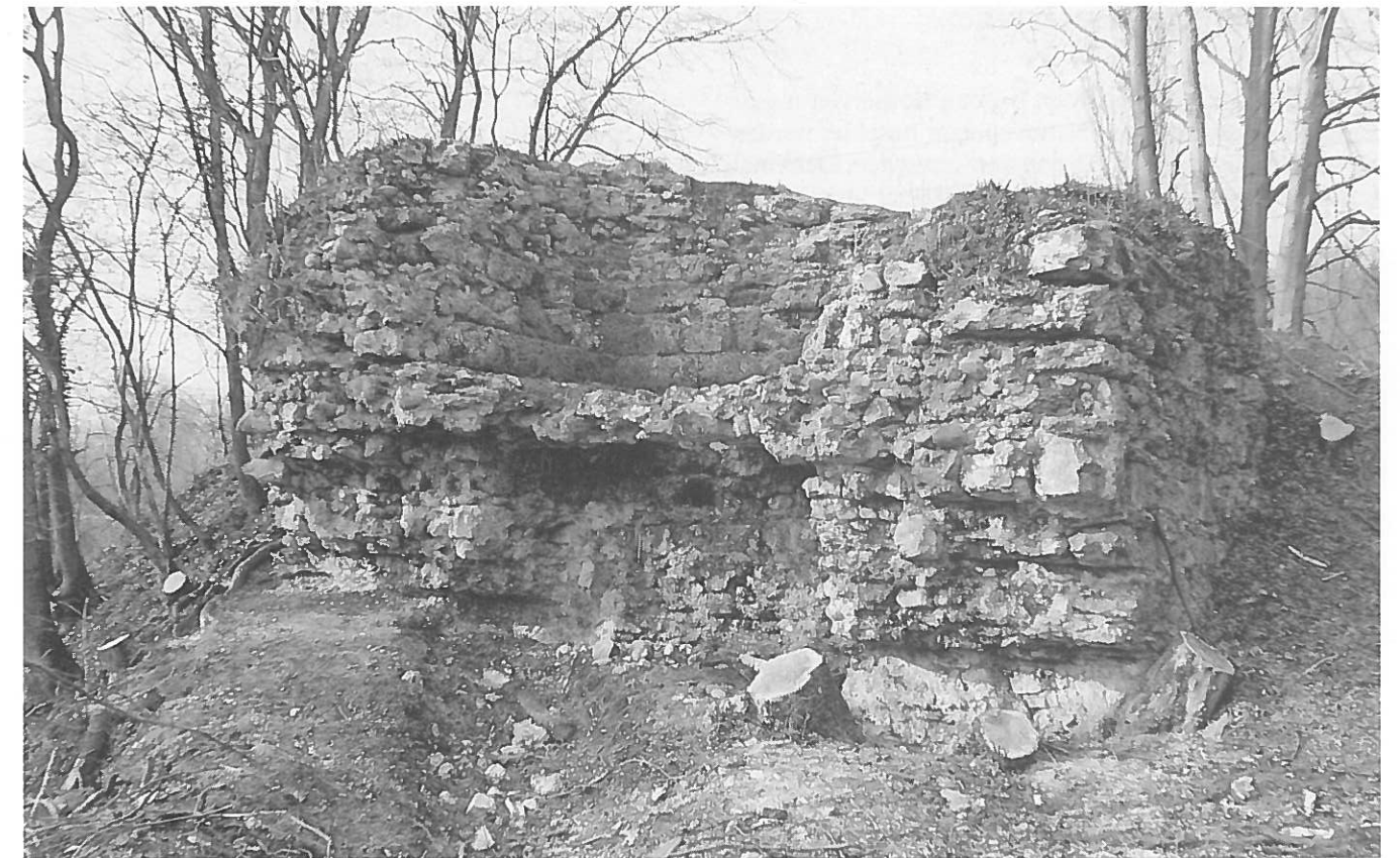
Zustand der Turmruine vor Beginn der Konservierungsarbeiten im Frühjahr 1987.
