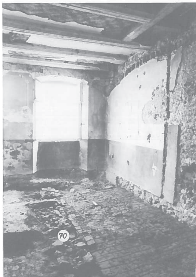
Abb. 30: Raum 3: Rechts die Westmauer der Kapelle, links unten das Brüstungsmauerchen Nr. 70 des gedeckten Vorbaues mit Tonplatten als Bodenbelag.
