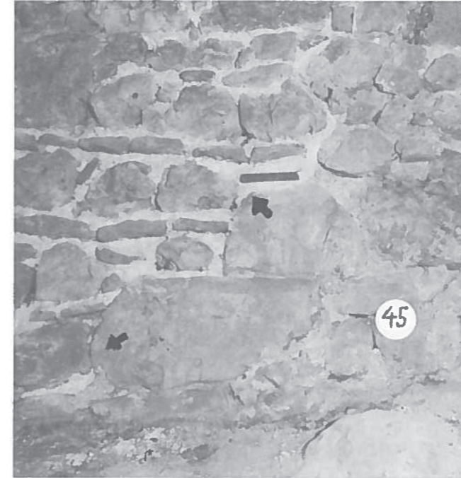
Abb. 15: Ansicht von Osten an die Aussenmauer der Kapelle/Kaplanei: Nr. 45 bezeichnet das ältere, 1466 brandgeschädigte Fundament; links der Pfeile das jüngere Fundament Nr. 2.
