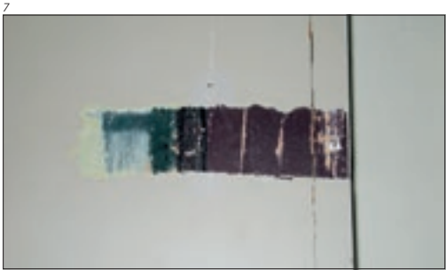
Abb. 7 Farbsondierung an den Türgewänden der Eingangshalle. Der graue Anstrich überdeckt die ursprüngliche, zweifarbige Fassung.
